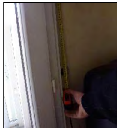
Ancrages insuffisamment espacés
