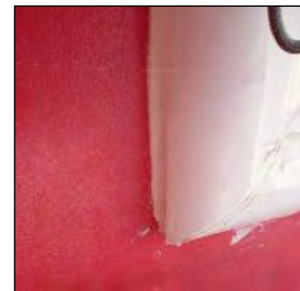
Problèmes finition + angle aile recouvrement trop saillant
